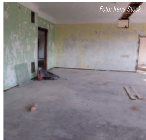
„überraschendes Ergebnis der Untersuchung – der Fußboden im großen Saal ist asbesthaltig“
